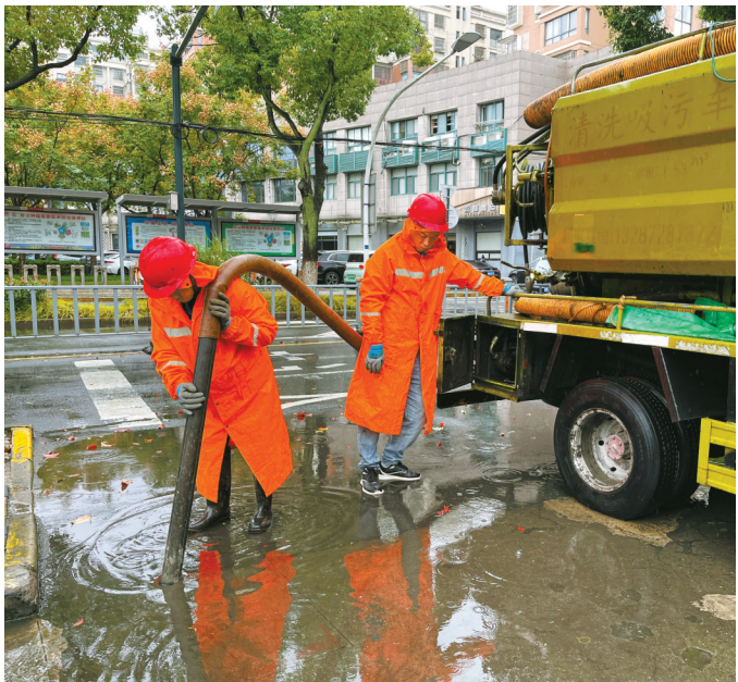
工作人员正在清理道路积水。
