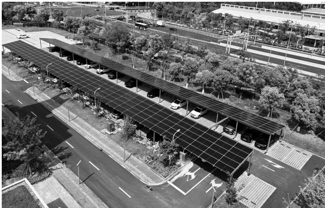
宁波工程学院光伏车棚。学校供图
