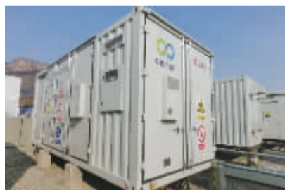
超级电容储能系统。
