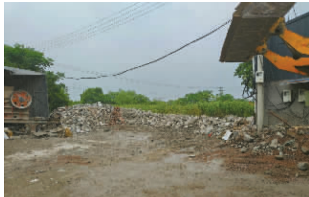
非法建筑垃圾处理点位已经关停。
