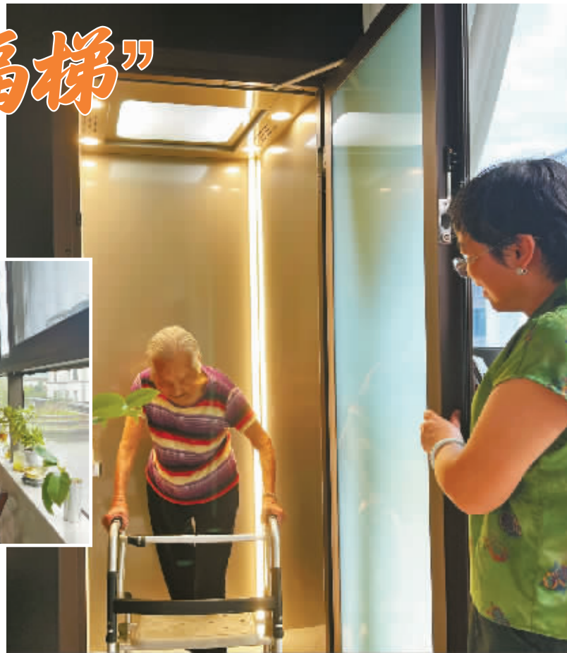
▶姜红萍专门为外婆安装的电梯。
