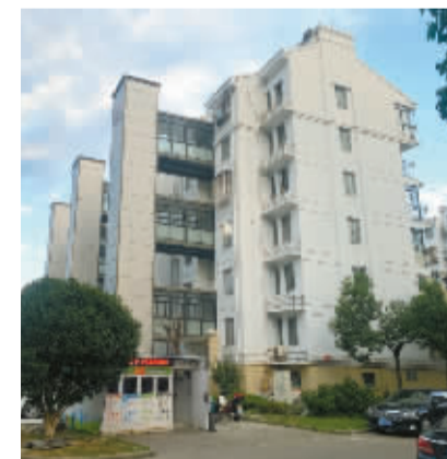
幸福苑小区加装的电梯。
