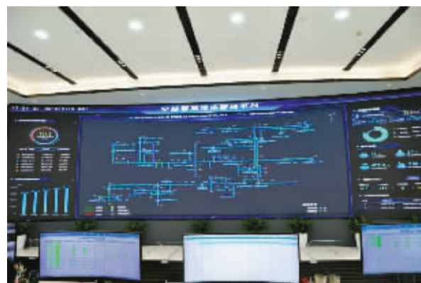
三座泵站纳入水务集团一体化调度平台。
