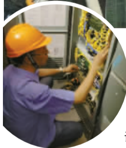
◀ 检验人员正在检查电梯。
