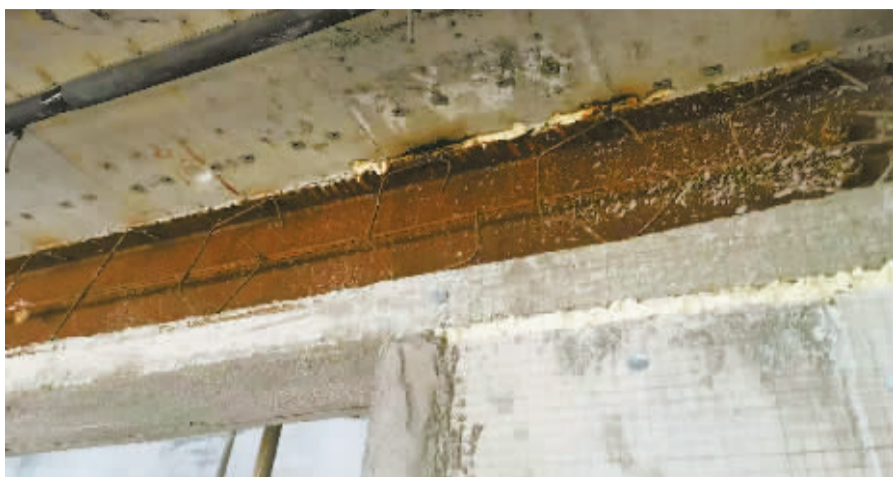
钢筋全部裸露在外，早已满是锈迹。
