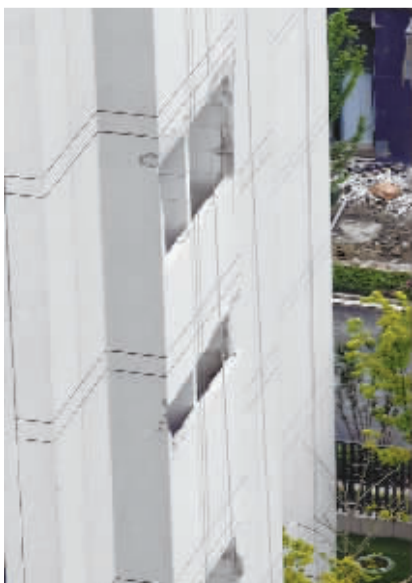
被打开的墙体缺少构造柱。
