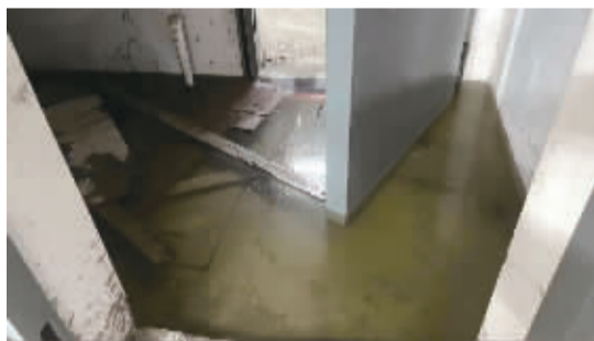
地下车库多处渗水。
