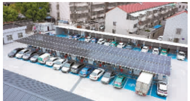
慈溪中石化光伏充储充电站。
