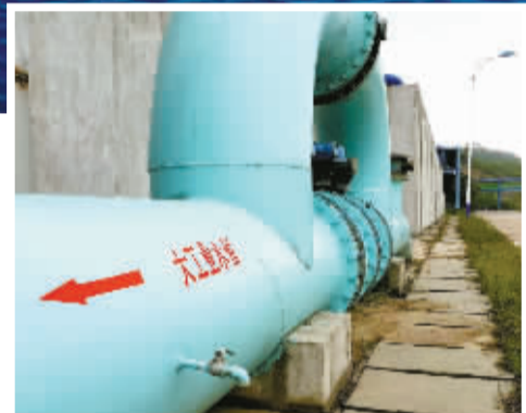
大工业输水管道
