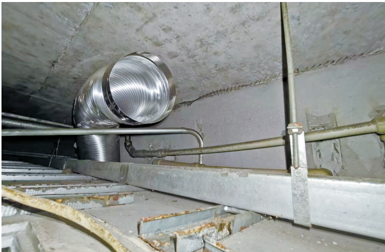
王女士家的吊顶内无排烟管道。
