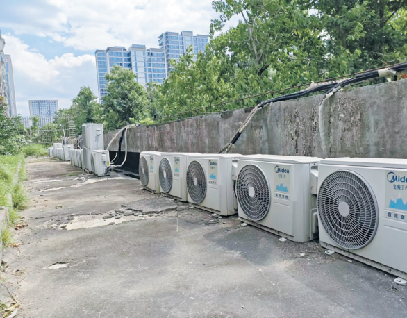
19台商铺空调外机放在平台西侧矮墙旁。(石景 摄)
