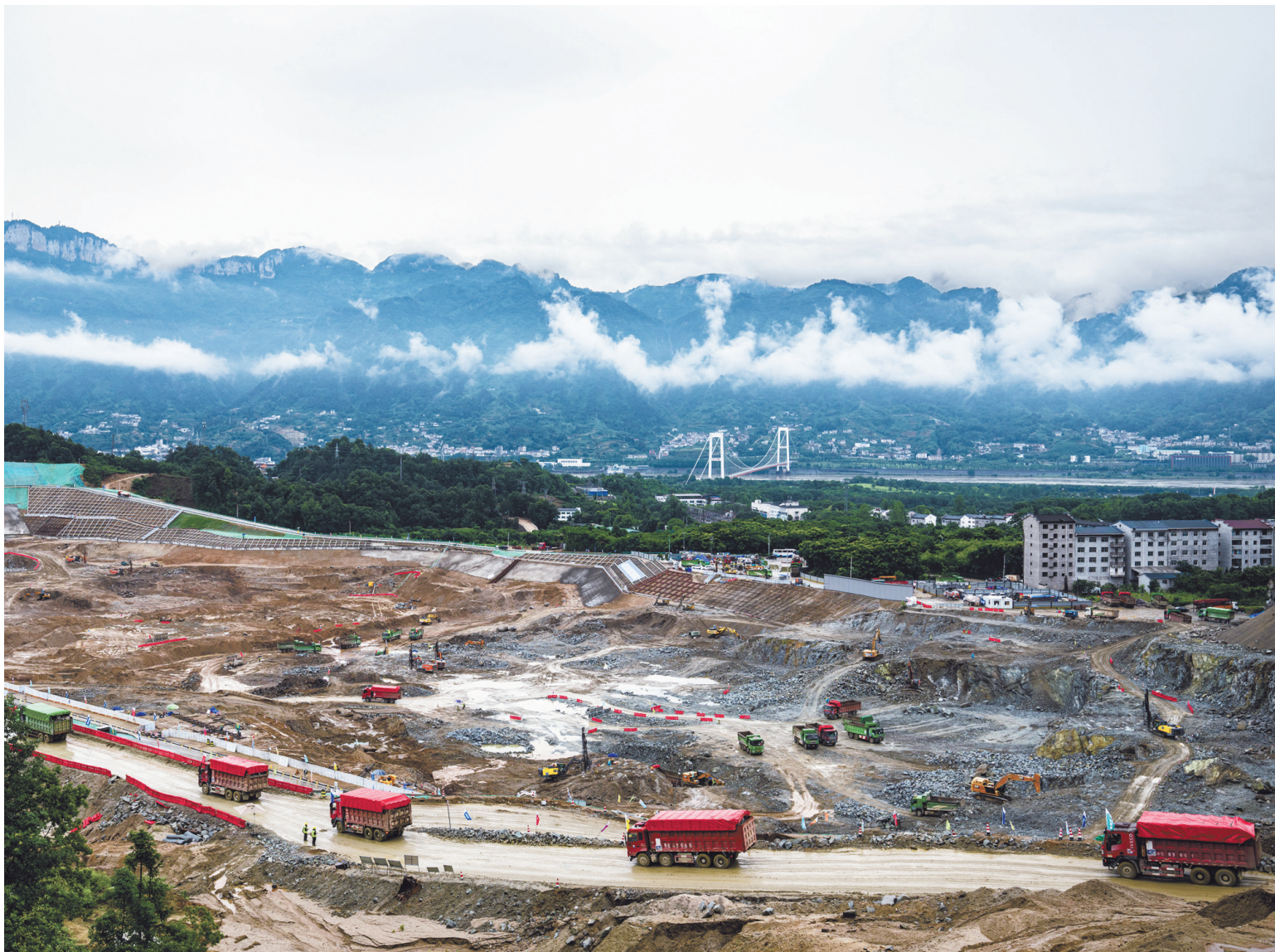
这是6月8日拍摄的三峡水运新通道工程先行开挖区施工现场。
