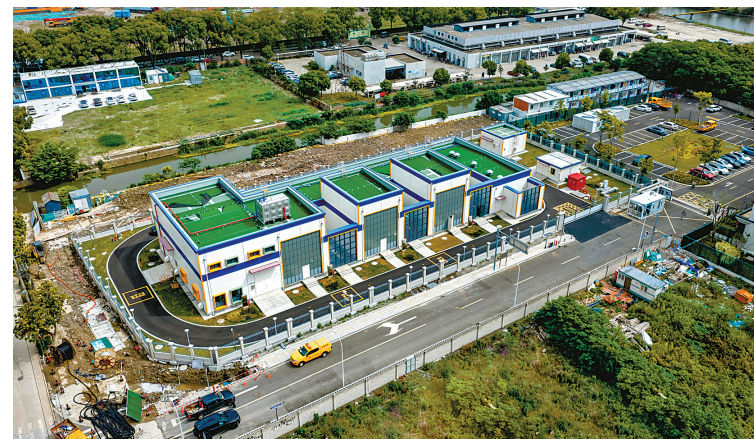
110千伏方家变电站。
