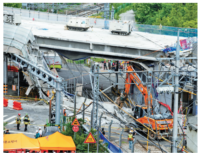
这是5月26日在韩国首尔拍摄的高架桥坍塌的事故现场。韩国首都首尔一座高架桥的拆除现场26日下午发生坍塌事故,目前已造成3人死亡、至少3人受伤。(新华社发)
