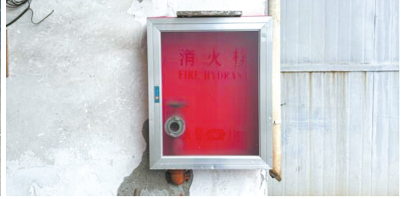
消火栓箱内缺失水带。（方琴 摄）
