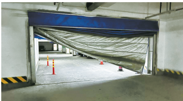
防火卷帘脱轨。（钟海雄 摄）
