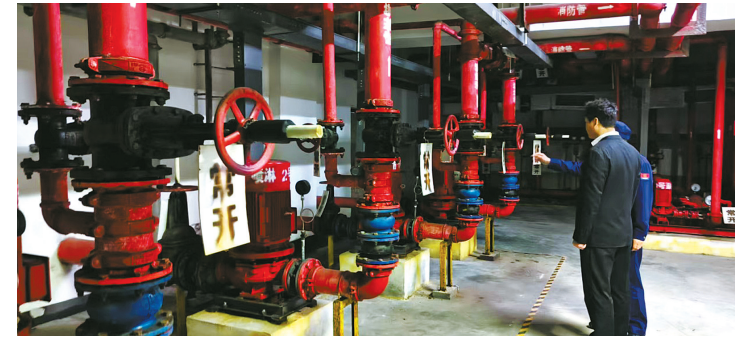
消防救援人员会同小区物业管理委员会人员手动测试消防喷淋系统。
