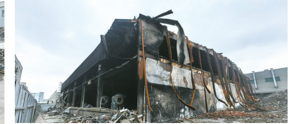
隔壁工厂厂房遭受烟熏火烤，也损坏严重。（余建文 摄）
