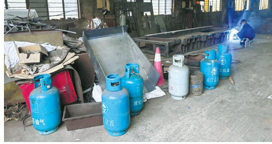
电焊作业区旁随意放着液化气瓶。
