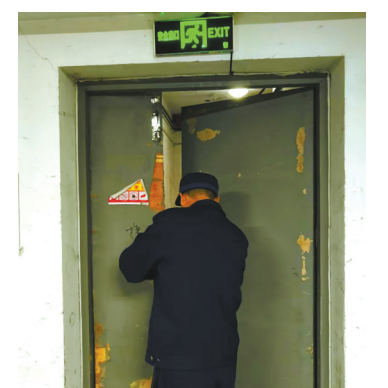
小区部分疏散指示标志已修复，但一些防火门仍无法密闭。（杨绪忠 摄）
