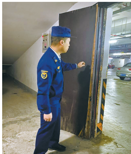
常闭式防火门还存在破损变形问题。
