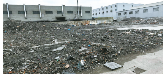
诗晨电器公司发生火灾之后，损毁严重的厂房已被拆除。
