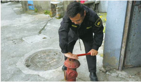
个别室外消火栓无法出水。（仇龙杰 摄）
