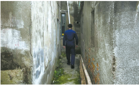
房屋之间道路狭窄，防火间距不足。
