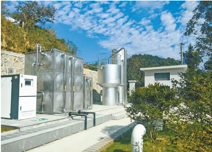
水站净化消毒设备。
