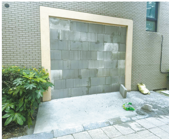
8月4日，门洞已用砖块封上，但与周边墙体差异明显，毁绿区域尚未恢复原状。
