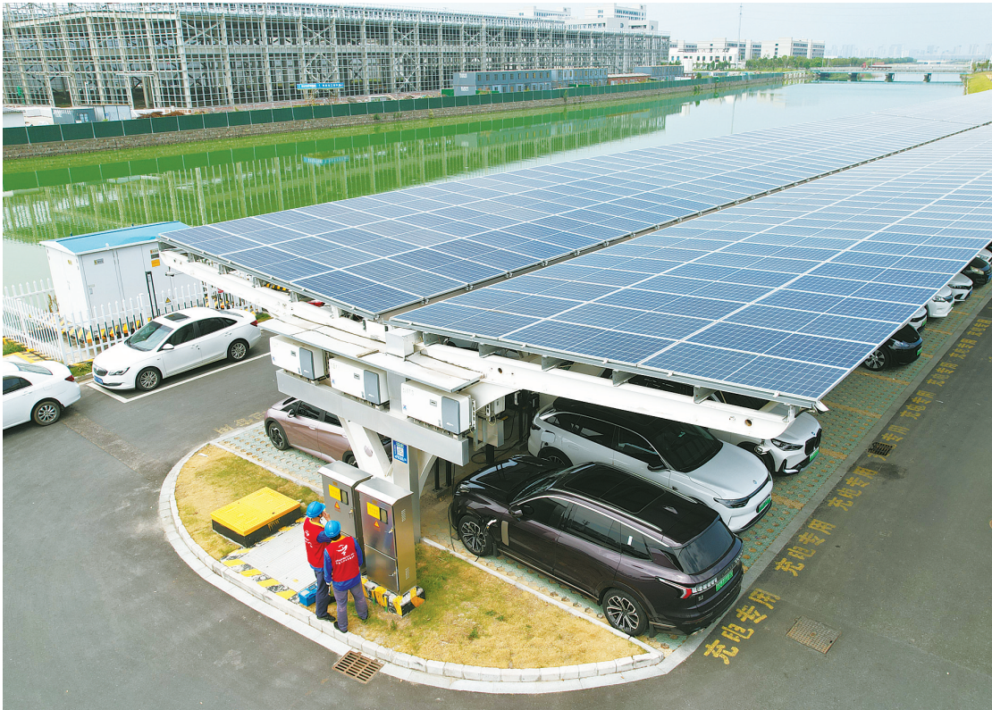
国网宁波杭湾供电分公司工作人员来到前湾新区银湾东路零碳驿站，对设备进行检查。
