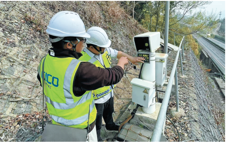
重点边坡安装了智能监测设备。
