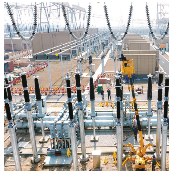
国网宁波供电公司开展500千伏变电站设备自主检修。(王幕宾 摄)
