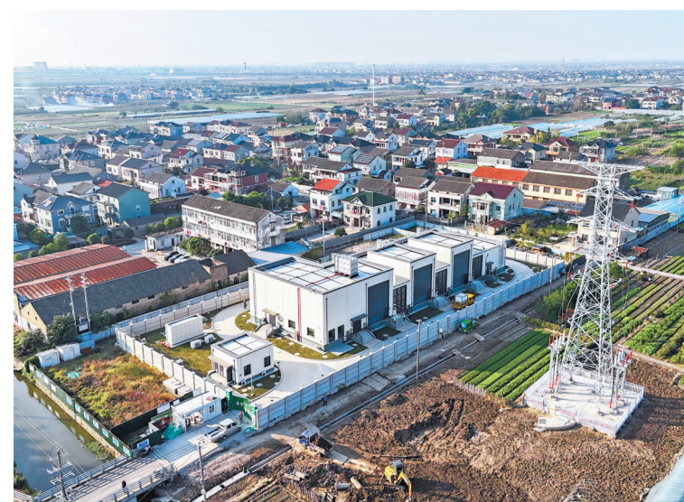
路桥110千伏变电站。
