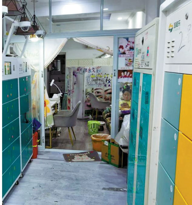
海曙区一换电柜场所设在美甲店内。
