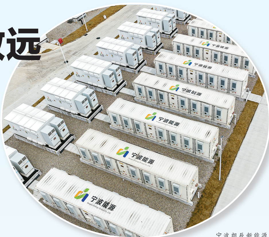
宁波朗辰新能源有限公司独立储能电站。
