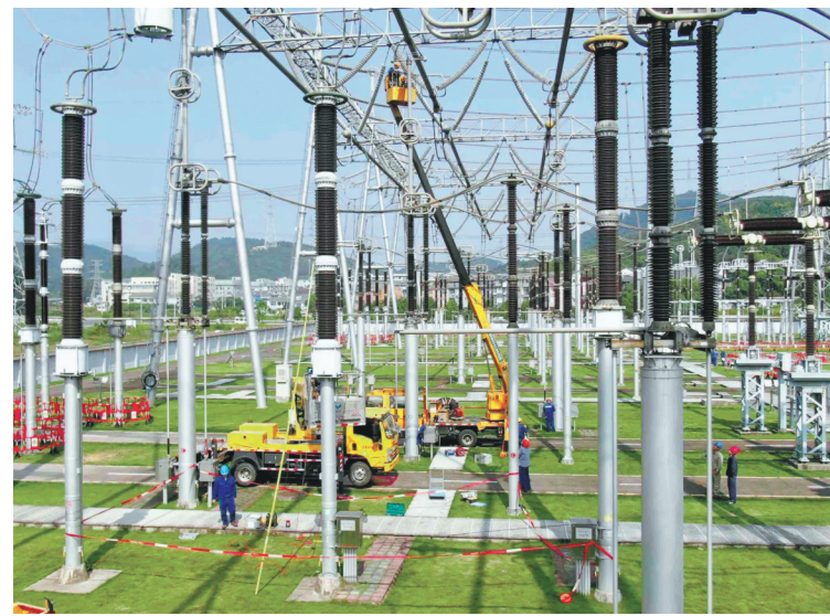
昨日，在500千伏宁海变电站，40余名检修人员在高大交错的输电线路间穿行，他们正在对电力系统进行秋季“体检”。今年宁波500千伏电网秋季检修工作预计历时三个月，涉及宁海变、春晓变等10座500千伏变电站51项生产任务，从野外的输电杆塔、架空线路、避雷器，到变电站里的变压器、隔离开关、断路器，再到街边的电线杆、配电变压器、环网柜，以及各种电力自动控制装置等，都在本次秋检范围内。（赵煜 姜映雪 摄）
