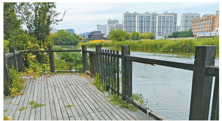
沿河护栏破损宛如“缺牙龙”。
