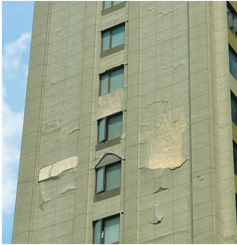
住宅楼外墙斑驳不堪。
