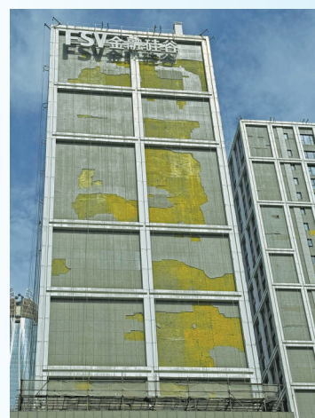
7号楼东面墙体大面积脱落，露出了内部的黄色。（仇龙杰 摄）
