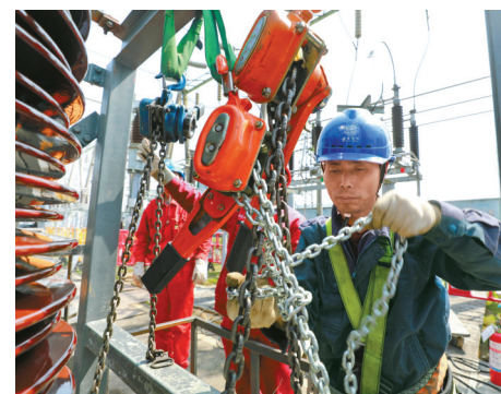
变电检修人员在北仑220千伏芦江变电站开展设备维护。
