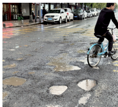
北斗东路上存在大量坑洞。
