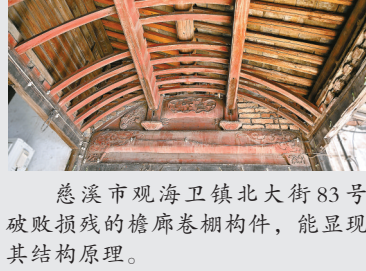
慈溪市观海卫镇北大街83号破败损毁的檐廊卷棚构件，能显现其结构原理。
