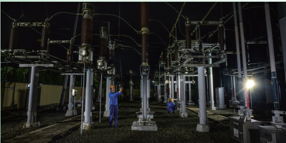
区供电公司员工在高压变电站开展设备巡检
