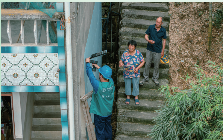
区供电公司小草电力志愿服务队到尚田街道张家坑村安装光伏路灯
